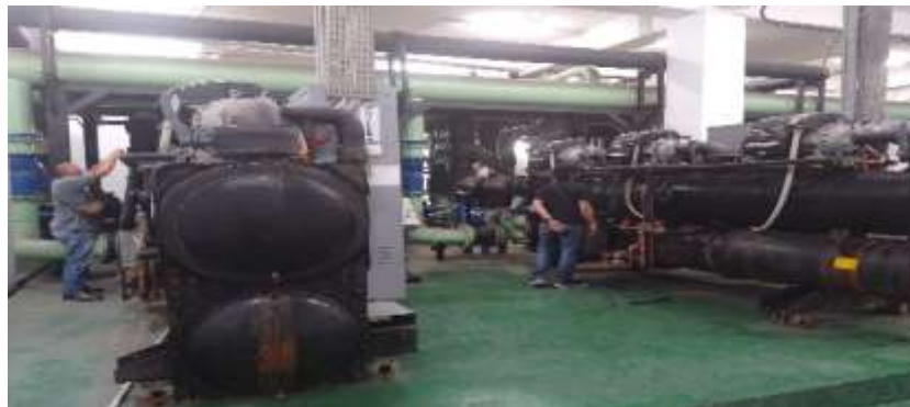
Gambar 1. Mesin Chiller Pada PT. X.
